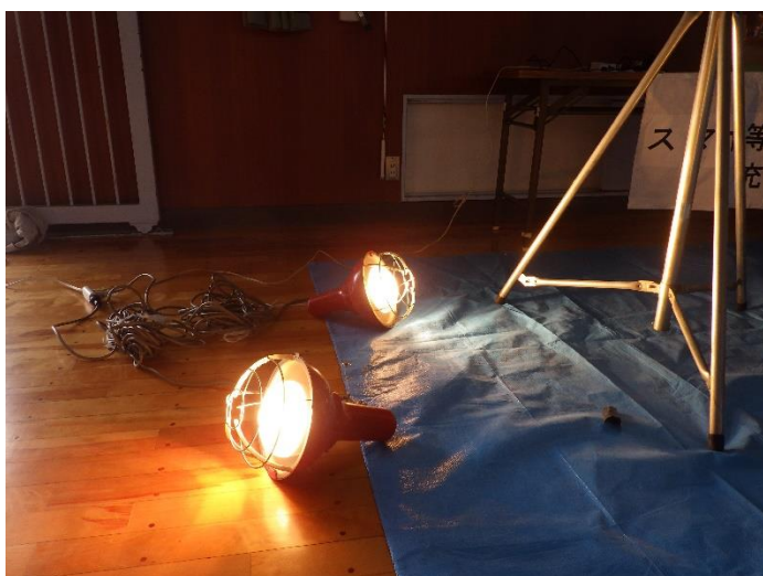
発電機を利用した投光器
