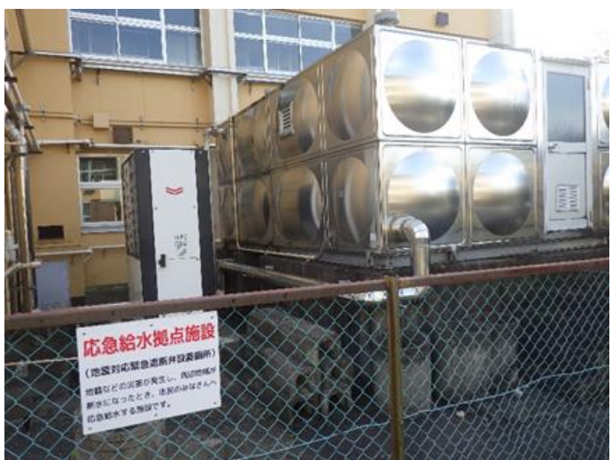
小学校中庭にある応急給水拠点施設。常に10トンの水道水が貯留されています。
